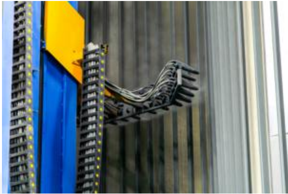
Dây chuyền sơn tĩnh điện đứng, sử dụng hệ thống súng Wagner (Đức)
